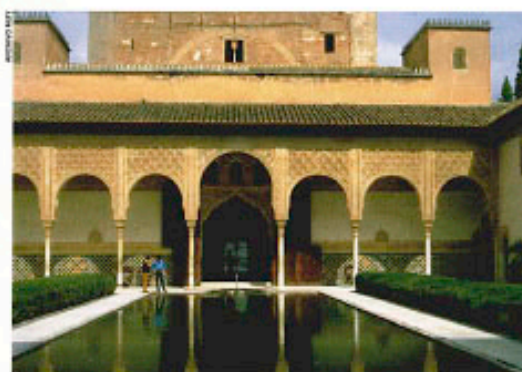
Un monumento en peligro Al comenzar las obras en una parte de la Alhambra, el Generalife, han aparecido colonias de termitas. Los tratamientos ya se han iniciado con resultados satisfactorios.
